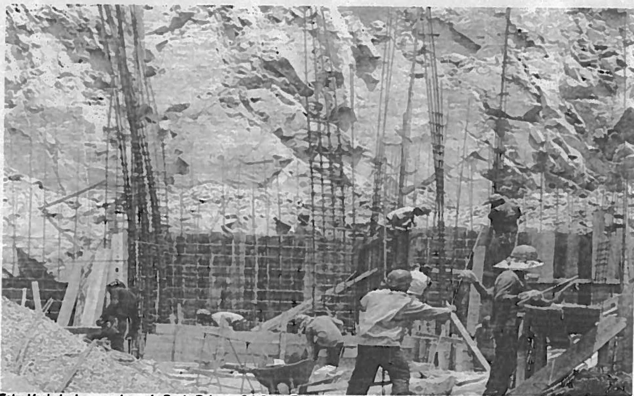
Foto: Vaciado de concreto en Jr. Punta Pejerrey Cd. 5 Urb El Sol de La Molina, La Molina 14.01.2011.
