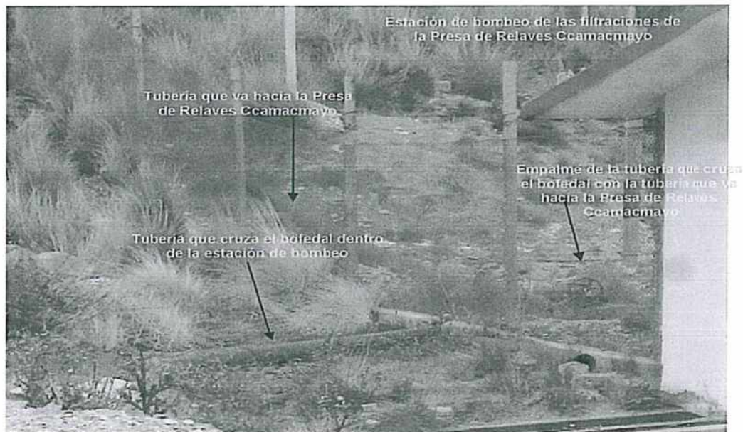
Fotografía N o 07.- Empalme de la tubería que cruza el bofedal con tubería que va hacia la presa de relaves Ccamacmayo
