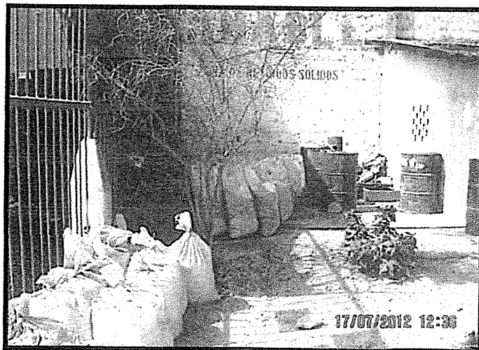
El Almacenamiento de Residuos Peligrosos no se encuentra cercado ni cerrado. Asimismo, se observa que el suelo está parcialmente impermeabilizado.
