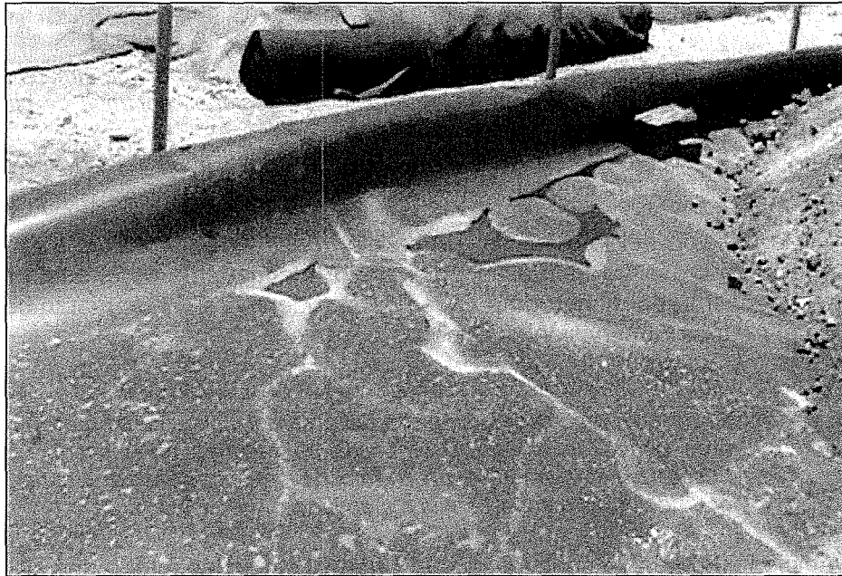
Fotografía N° 8: Impermeabilización de la disposición temporal de material derramado
