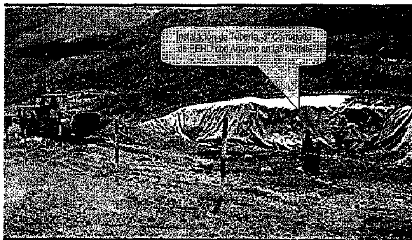
Fotografía 02: Instalación de desfogue de Biogás
