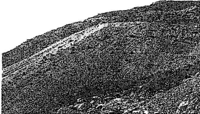
FOTO N° 14: Vista del botadero de desmonte en Patibal Medio, no cuenta con canal de coronación y canal de drenaje.
