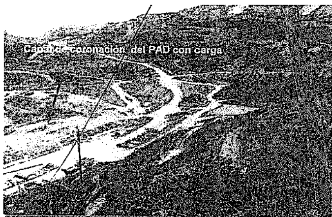
FOTO N° 38: Vista del PAD de lixiviación, obsérvese el canal de coronación cubierto por mineral, incumpliendo lo que indica en el EIA aprobado por R.D. N° 393-2007-MEM/AAM
