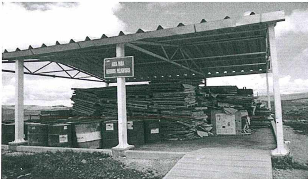
FOTO N° 29: EN LA ESTACION CENTRAL DE RESIDUOS, SE ENCUENTRA EL DEPOSITO DE ACEITES USADOS JUNTO A RESTOS DE MADERA DE LAS CAJAS DE CIANURO, QUE NO CUENTA CON CERCO PERIMETRICO NI TAMPOCO CON UN LETRERO DE SENALIZACION QUE INDIQUE SU PELIGROSIDAD.
