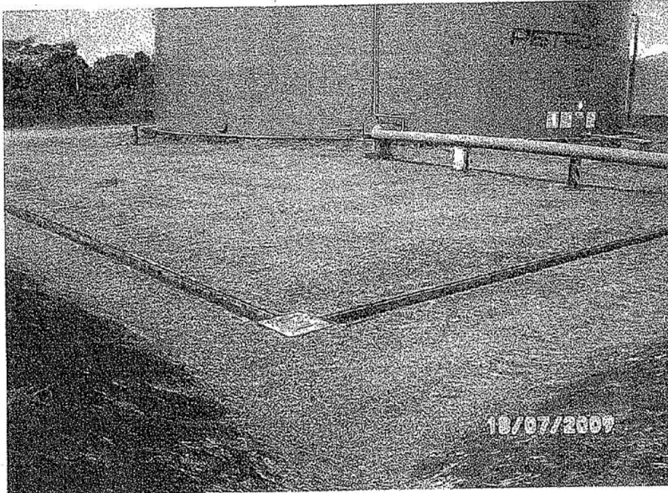
Figura N° 4. SARAMURO. Se muestra el área estanca de almacenamiento de hidrocarburos, sin indicios de estar impermeabilizada.
