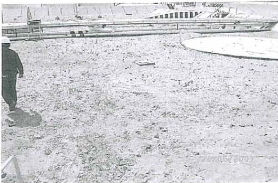
Figura N° 2. Se aprecia el área estanca del área de tanques del Terminal no impermeabilizada.
