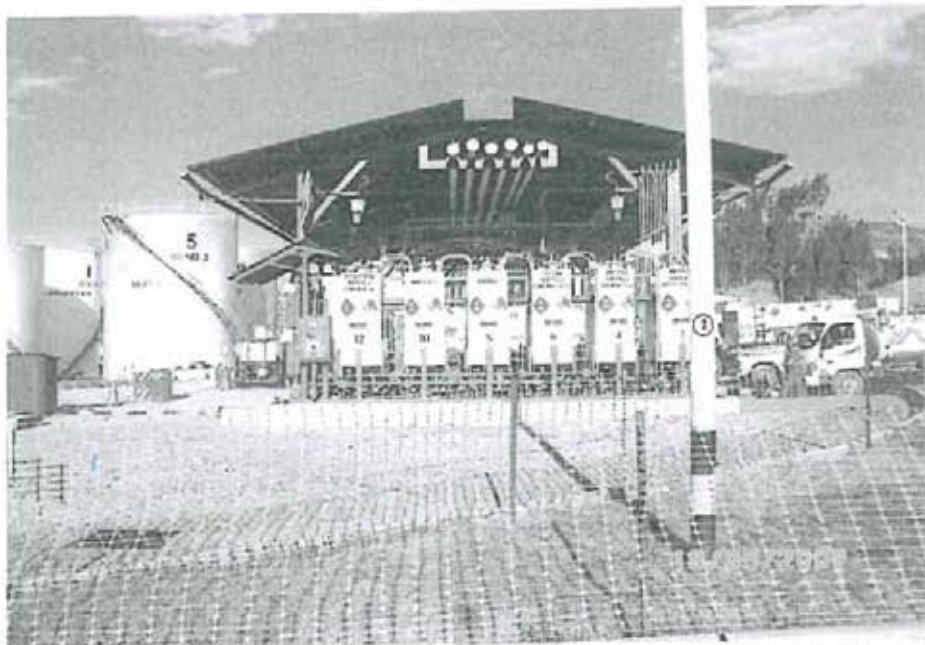
Figura N° 8. Se muestra el tren de tanques dosificadores de aditivos químicos, debidamente instalados dentro de una poza de loza de cemento y sardinel.
