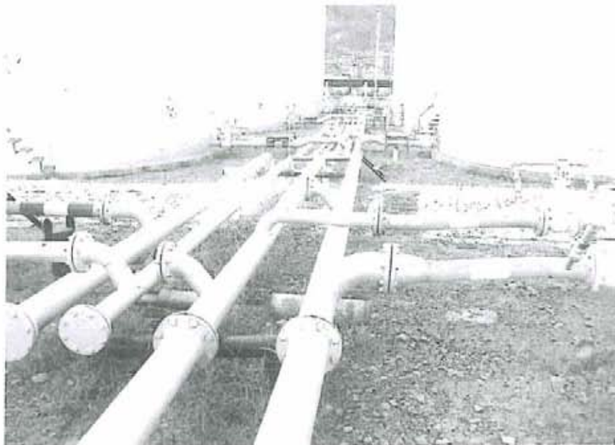
Figura N° 4. Se muestra la zona estanca del área de tanques, no está impermeabilizada.
