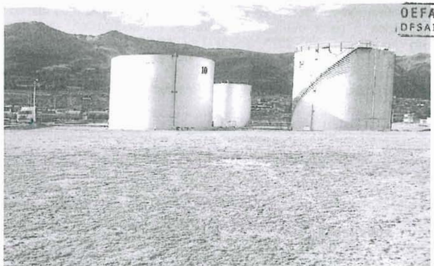
Figura N° 3. Se puede apreciar que la zona estanca del área de tanques no está impermeabilizada.
