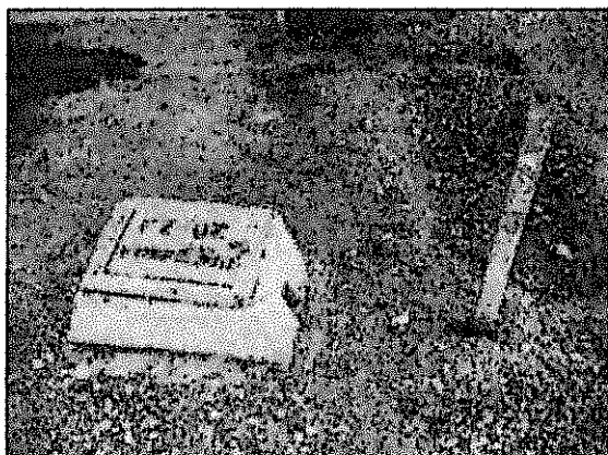
Foto N° 2a: Instalación de Piezómetro PZ - 02, ubicado de la parte baja de los Pads de lixiviación.
