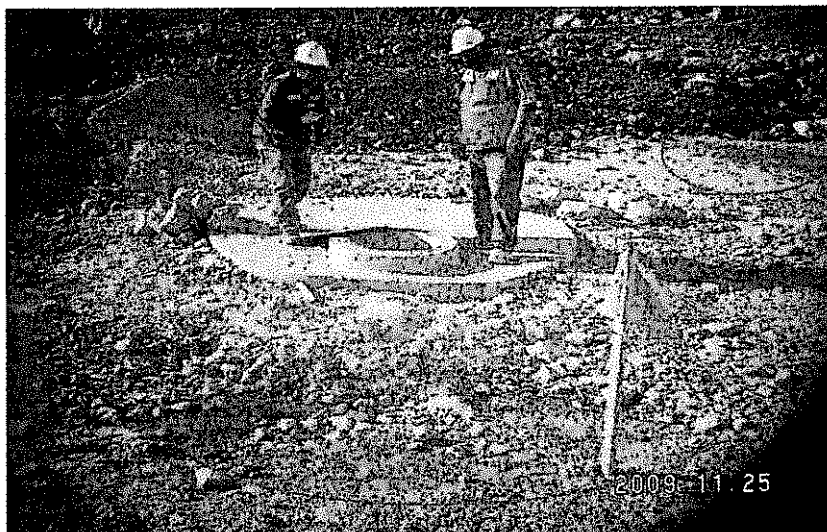
Fotografía 35: Inspección del sistema de tratamiento de las aguas domésticas no cumple con los parámetros de diseño técnico, lo constatado muestra un pozo ciego o letrina.
