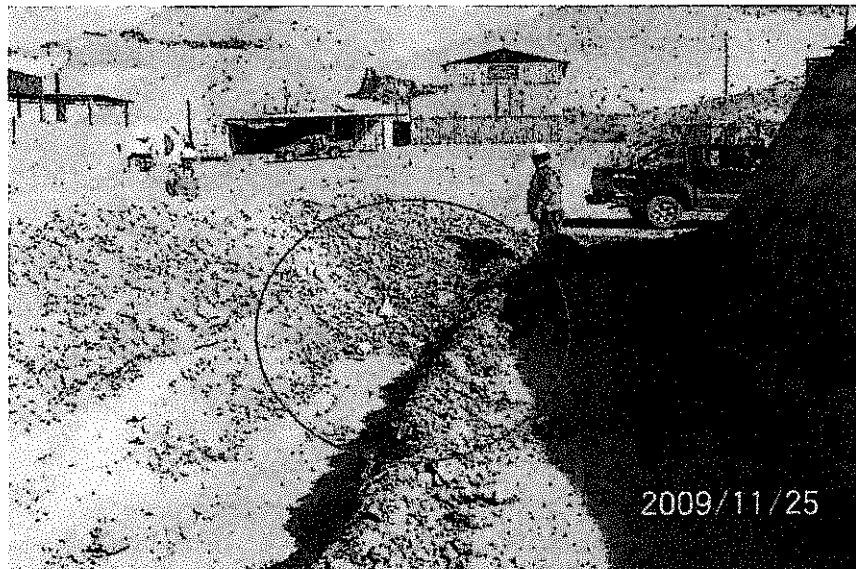
Fotografía 21: La empresa minera ha construido aproximadamente 500 m, 20% de canal de coronación sobre terreno natural en el costado derecho parte baja del depósito de desmontes Cuprita, estando actualmente incompleto, no cumple con la recomendación N° 1 126 de la Supervisión Regular 2008.
