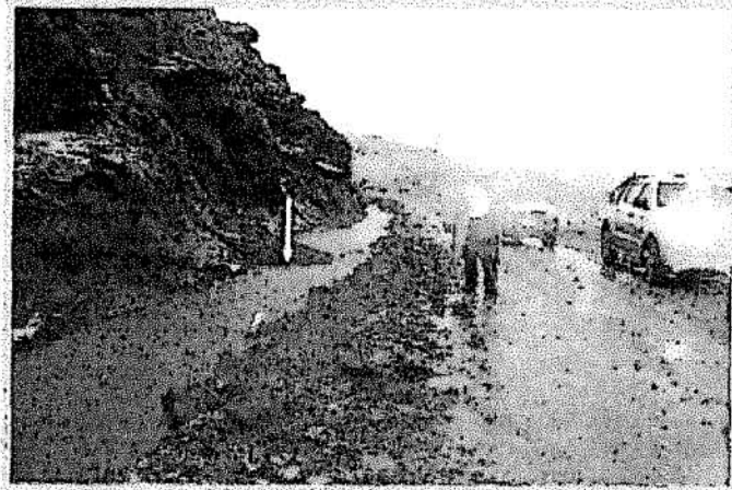
Fotografía N° 113: Canal de coronación del depósito de desmontes Esperanza 1, construido sobre terreno natural incumpliendo lo establecido en el EIA, UEA Animón.
