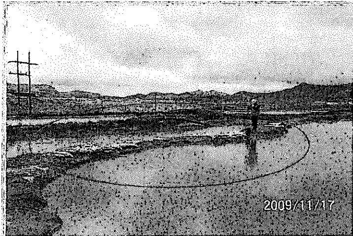
Fotografía N° 76: Poza de sedimentación de la planta de tratamiento de agua de mina, nótese la irregularidad de los taludes y encimado con sacos metaleros, UEA Animón.
