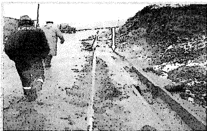
Fotografía N° 116: Canal de coronación de sección trapezoidal colapsado por las aguas de escorrentía provenientes de las precipitación de la estación, Esperanza N° 1, UEA Anímón.
