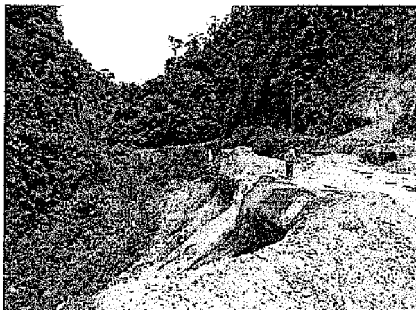
Foto N° II.14.12: Acceso con presencia de desmontes, sin estructuras hidráulicas ni obras de estabilidad en la margen derecha de la Qda. Puntayacu.
