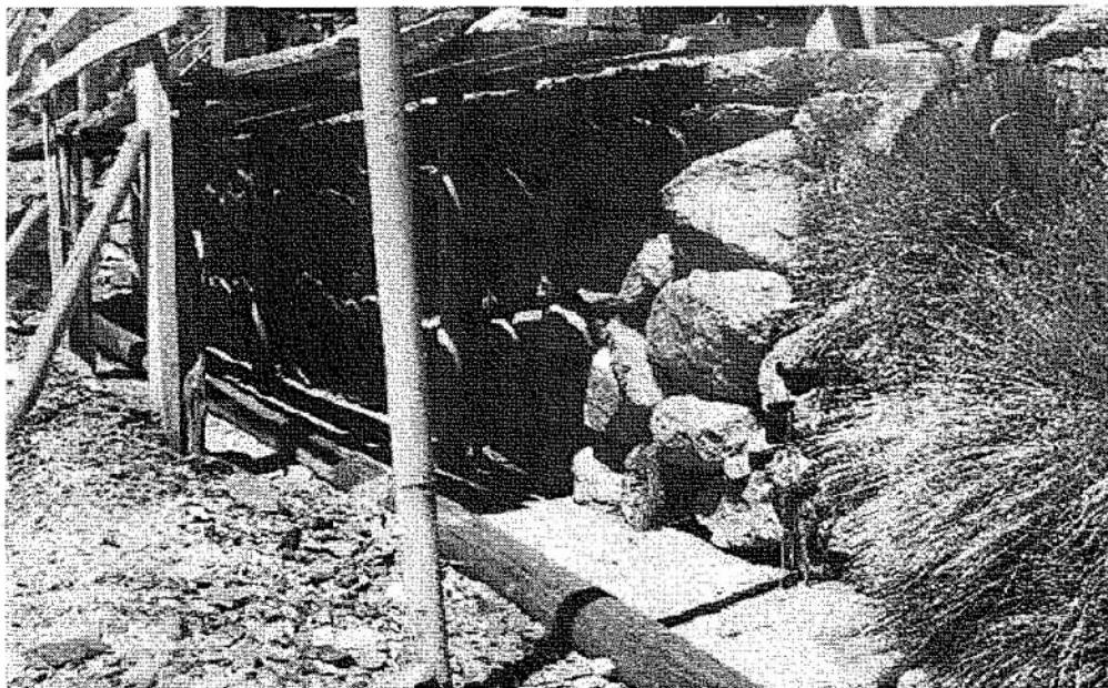
FOTO N° 17: SE OBSERVÓ POR DEBAJO DEL RELLENO HIDRÁULICO RESTOS DE RELAVES SOBRE UN CANAL DE TIERRA A CAUSA DE DERRAMES DEL MEZCLADOR.
