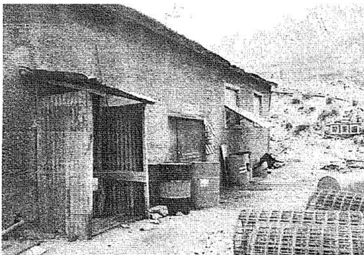
Foto N° 40. Recomendación N° 02: cilindros con hidrocarburos sin contención ante posibles derrames fuera del Depósito de Lubricantes..
