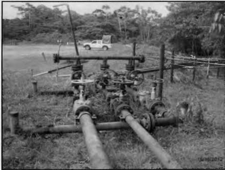
Fotografía N° 20 del Informe N° 219880-2012-GFHL-UPPD: Manifold a donde están conectadas las líneas de flujo de los pozos, sin protección contra la corrosión.
