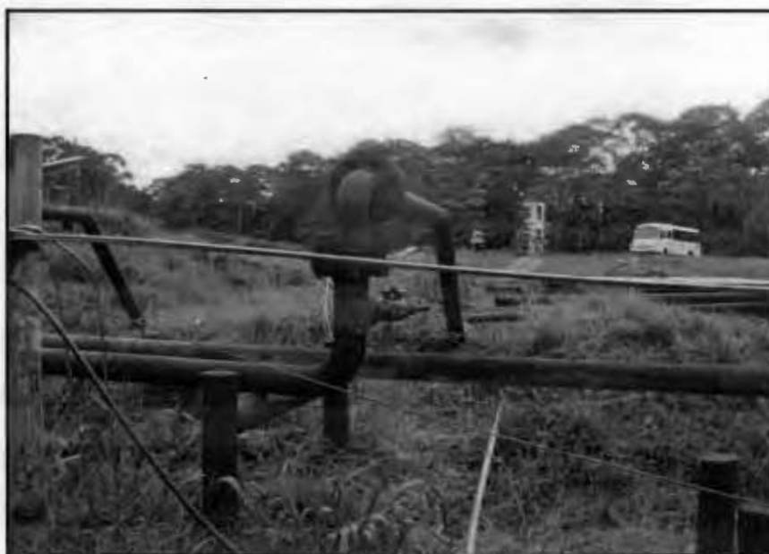
Fotografía N° 18 del Informe N° 219880-2012-GFHL-UPPD: Tuberías, línea de flujo que sale del Pozo CS18 y de reinyección que entra al pozo reinyector.
