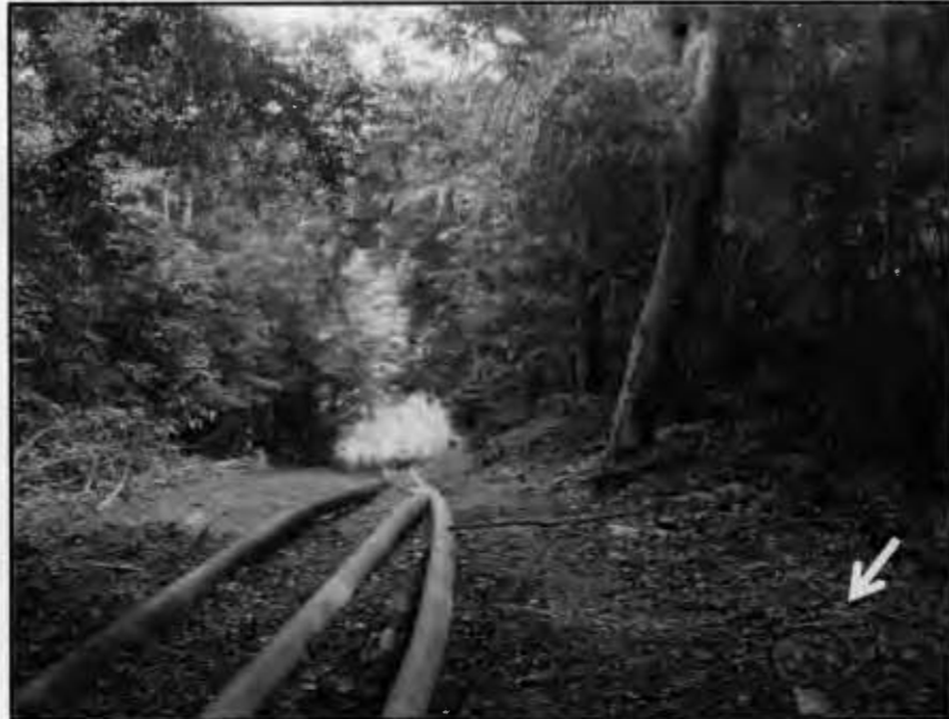
Fotografía N° 21 del Informe N° 219880-2012-GFHL-UPPD: Líneas de flujo de los pozos que se encuentran tendidos sobre la superficie del terreno y sin ninguna protección contra la corrosión.
