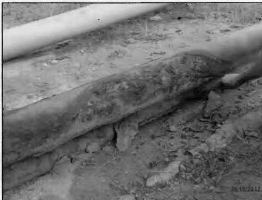
Fotografía N° 26 del Informe N° 219880-2012-GFHL-UPPD: Vista más cercana de la tubería en mal estado y se observa que la tubería operativa también tiene signos de encontrarse en mal estado.
