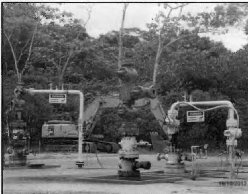
Fotografía N° 13 del Informe N° 219880-2012-GFHL-UPPD: Se muestra el Pozo CS18 en estado productor, el Pozo CS19 estado ATA y Pozo CS 20 inyector de agua de producción. Cabezal del pozo productor manchado con petróleo por fuga en el mimimandrel.
