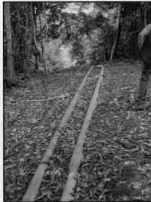
Fotografía N° 22 del Informe N° 219880-2012-GFHL-UPPD: Otra vista de la tubería tendida sobre el suelo sin ninguna protección contra la integridad de la tubería.
