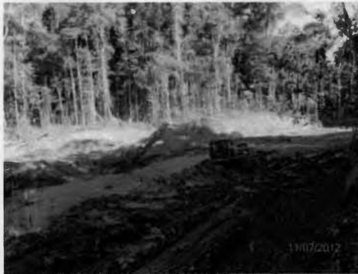
Fotografía N° 2 del Informe de Supervisión N° 692-2012-OEFA/DS: Vista de los trabajos de rehabilitación de la laguna Shanshocochoa, ubicada en Capahuari Sur, mediante el método Landfarming (Coordenadas UTM – Sistema WGS 84: 030491E, 9692282).
