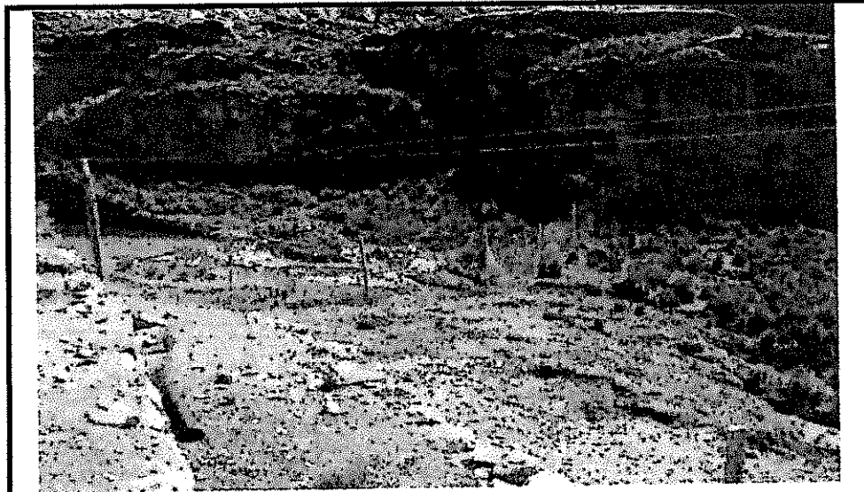
Foto N° 16.- Poza de sedimentación que capta subdrenes del Depósito de Relaves. (Costado de la poza de sedimentación N° 2) Se puede observar que está recubierta con geomembrana y está cercada con malla..
