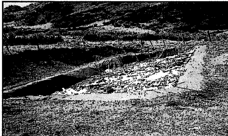
Foto N° 22: Relleno sanitario donde los residuos sólidos domésticos se encuentran a la intemperie y sin cobertura, no tiene puerta y tampoco tiene canales para las aguas de escorrentías, situado en la Unidad Minera "Andes 1"
