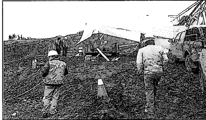
Foto N° 1.10: Plataforma de perforación en actividad carece de canal de coronación.
