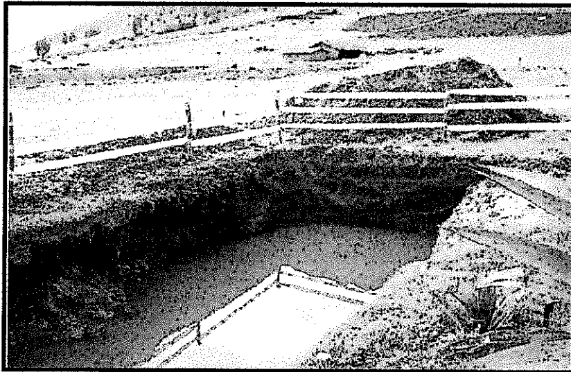
Foto N° 14: Otra vista de uno de los pozos ubicados en la parte posterior del Campamento La Arena, sin geomembrana ni tapa.
