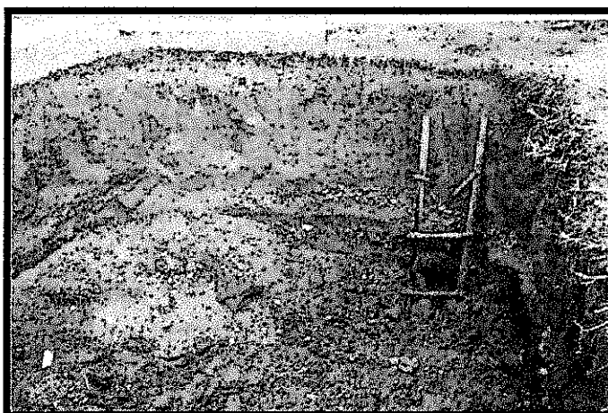
Foto N° 26: Segunda trinchera sin geomembrana, donde los residuos están cubiertos, sin cerco de seguridad.
