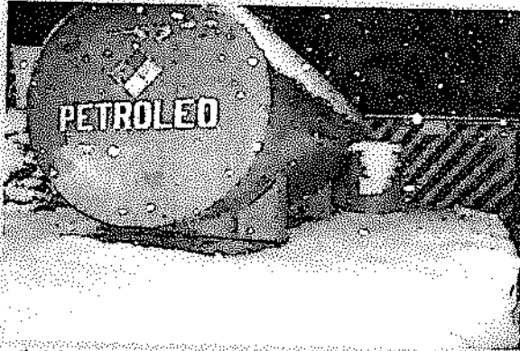
Fotografía N° 33: Tanque sistema de titular minero, no presenta poza para contingencia, Recomendación N° 8, PE Azuca
