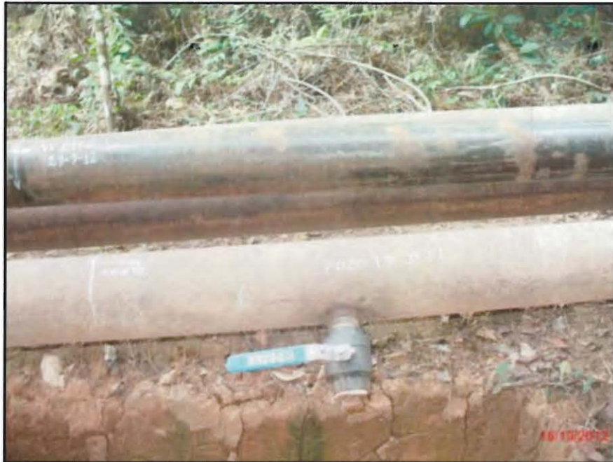
Fotografía N° 23 del Informe N° 219880-2012-GFHL-UPPD: Vista de la línea de flujo del Pozo CS20 de reinyección del agua de producción con una válvula de 2" y una tubería nueva para el cambio de tramo.
