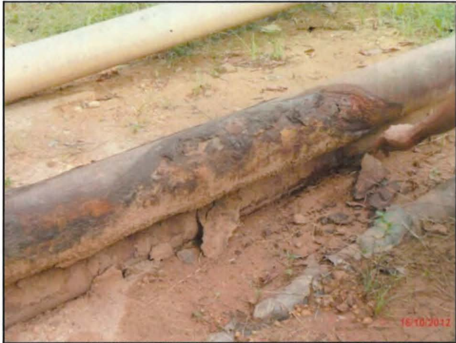
Fotografía N° 26 del Informe N° 219880-2012-GFHL-UPPD: Vista más cercana de la tubería en mal estado y se observa que la tubería operativa también tiene signos de encontrarse en mal estado.
