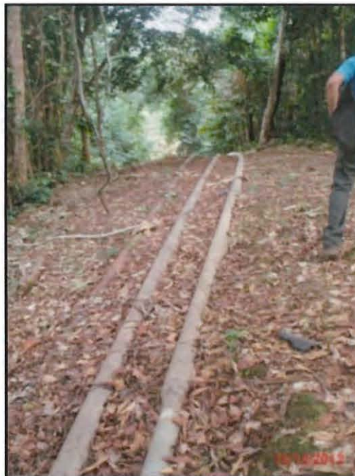
Fotografía N° 22 del Informe N° 219880-2012-GFHL-UPPD: Otra vista de la tubería tendida sobre el suelo sin ninguna protección contra la integridad de la tubería.
