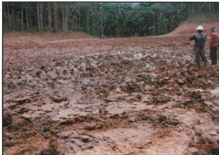
Fotografía N° 15 del Informe N° 219880-2012-GFHL-UPPD: Vista de la quebrada rellena con tierra arcillosa de los alrededores donde se observa la mezcla de distintos colores por la posible presencia de hidrocarburos.
