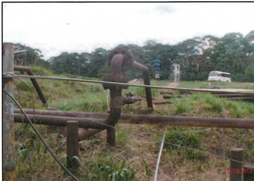
Fotografía N° 18 del Informe N° 219880-2012-GFHL-UPPD: Tuberías, línea de flujo que sale del Pozo CS18 y de reinyección que entra al pozo reinjector.
