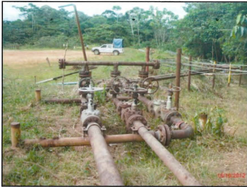
Fotografía N° 20 del Informe N° 219880-2012-GFHL-UPPD: Manifold a donde están conectadas las líneas de flujo de los pozos, sin protección contra la corrosión.
