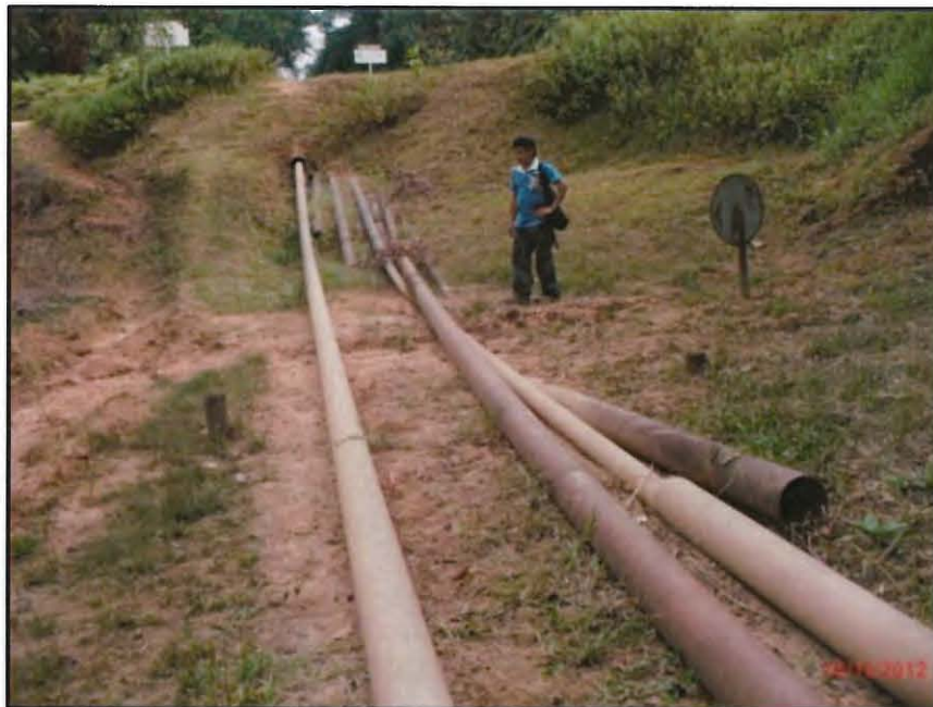
Fotografía N° 24 del Informe N° 219880-2012-GFHL-UPPD: Vista de las líneas de flujo de los pozos y otras tuberías que han sido abandonadas luego de los cambios efectuados a los tramos en mal estado.
