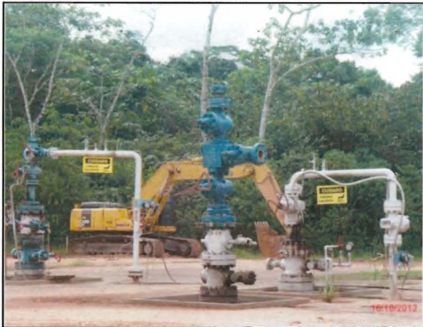
Fotografía N° 13 del Informe N° 219880-2012-GFHL-UPPD: Se muestra el Pozo CS18 en estado productor, el Pozo CS19 estado ATA y Pozo CS 20 inyector de agua de producción. Cabezal del pozo productor manchado con petróleo por fuga en el mimimandrel.
