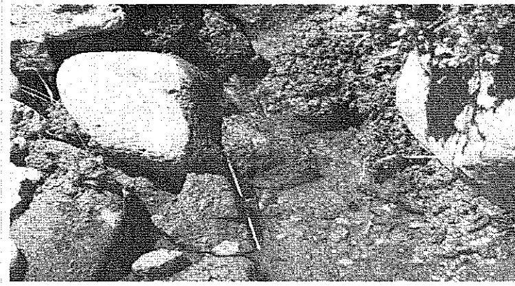
Fotografía N° 19: Zona sur este de la relavera, se evidencia filtraciones al pie del dique de la relavera.
