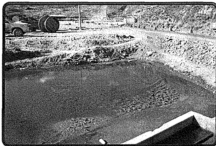
FOTO N° OR-1B: Obsérvese a la salida de la poza de sedimentación en superficie del Nv. 4450 Mina Carmen saturado con arenas y lodos.
