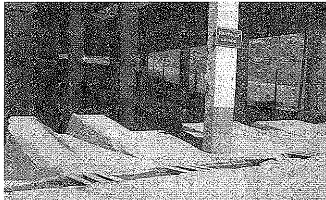
FOTO N° 31: Material acumulado en la cuneta de la rampa de lavado (taller de mantenimiento de Huaripampa).
