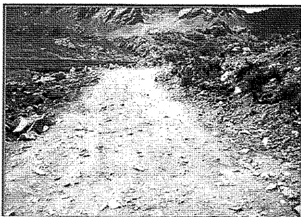
FOTOGRAFIA N° 28 - Vista del acceso cercano al campamento, nótese que no cuenta con cuneta ni señalización.
