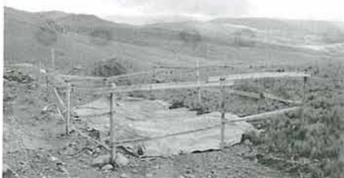
Fotografía N° 5: Estructuras temporales de disposición de aguas residuales domésticas del Proyecto de Exploración Anabi.
