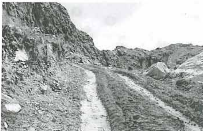
Fotografía N° 12: Pendiente y talud de corte en vía de acceso del sector Utunsa, sin cunetas.
