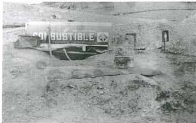
Fotografía N° 20: Almacén temporal de combustibles que muestra condiciones inapropiadas de operación.
