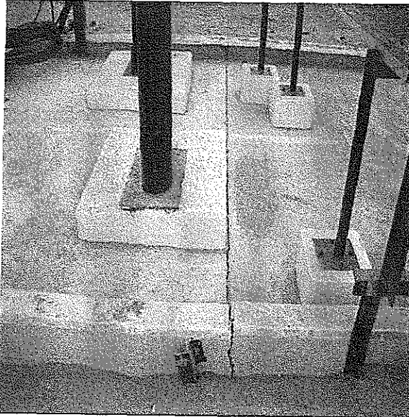
Foto 13. Losa con contención secundaria de concreto deteriorada en el área de recepción de LNG.
