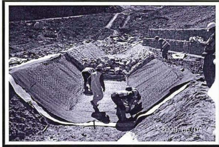
Foto 02. Construcción de canal de conducción y descarga proveniente de la captación (coronación) del Depósito de Relaves 1; las hojas de HDPE (geomembrana) están siendo pegadas con un dispositivo de calentamiento eléctrico.
