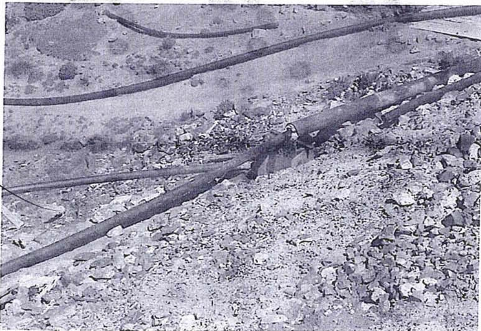
Foto N° 2: En el acople de las tuberías HDPE de 8" y 6" de diámetro, se observa que una parte de las aguas decantadas van hacia las pozas Wetland y otra parte van hacia la Laguna Yanacocha, sin tratamiento impactando sus aguas.
