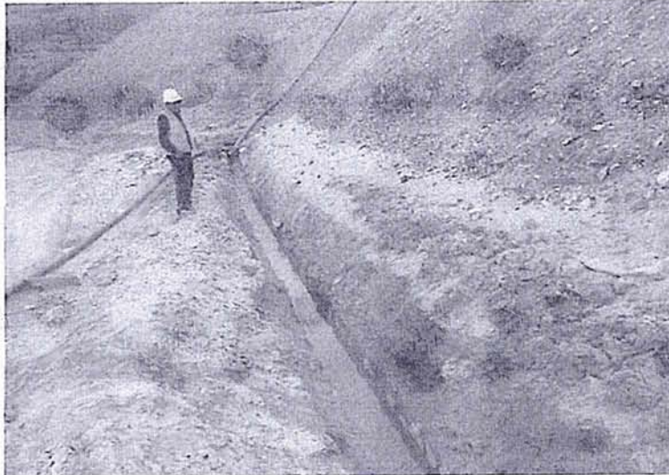
Foto N° 5: Canal de piedra y cemento al pie del talud de la cancha de relaves N° 1 que capta las aguas decantadas de la quena lado Este de la cancha de relaves N° 2, por donde son evacuadas hacia la Laguna Yanacocha sin tratamiento.
