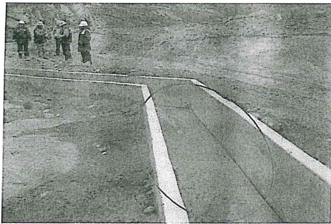
Foto N° 5: Canal de coronación con presencia de restos de relaves arrastrados por el viento y lluvia (Observación N° 1)
