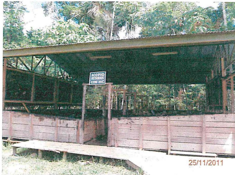
Fotografía N° 6 vista panorámica del centro de almacenamiento de restos de hidrocarburos ubicado en el Yacimiento Yanayacu, el cual no cumple con tener un sistema de drenaje, tratamiento de lixiviados, pisos impermeables, entre otros.
