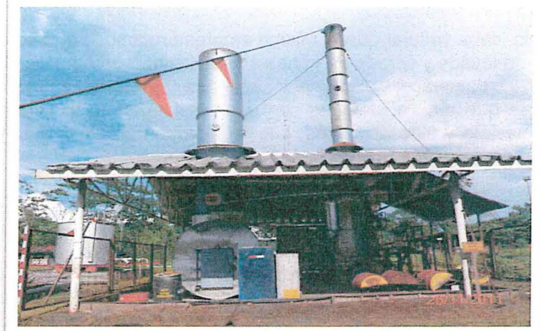
Fotografía N° 1: Vista panorámica del incinerador ubicado en el Yacimiento Corrientes , el cual durante la supervisión no contaba con sistema de lavado y filtrado de gases .
