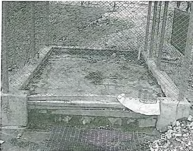
Fotografía N° 18: Vista del escurrimiento hacia suelo natural de los lixiviados y finos provenientes del lecho de secado de los lodos (residuo peligroso) de la planta de tratamiento de aguas servidas.
