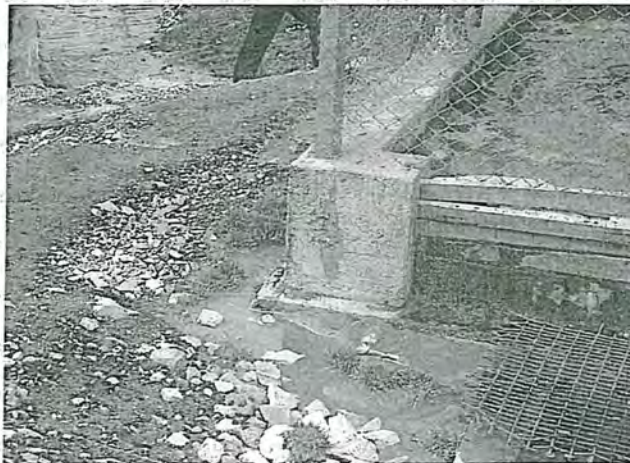
Fotografía N° 20: Vista donde se observa como las aguas de escorrenxia y los lixiviados (residuo peligroso) se mezclan y discurren libremente sobre el suelo natural y drenan al cuerpo de agua próximos, laguna Caballicocho.
