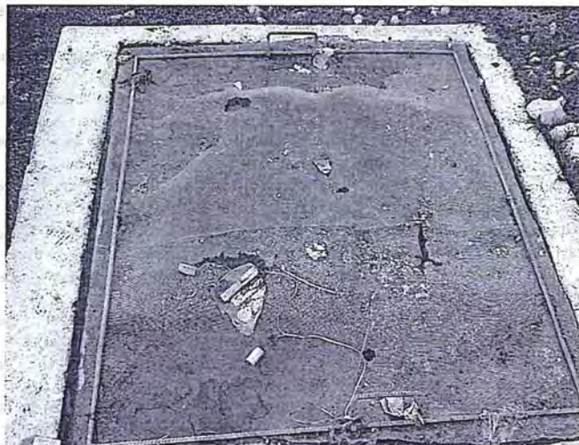
Fotografía N° 26: Vista del deterioro de la protección y seguridad que se da a la poza colector de lixiviados (residuo peligroso) de la planta de tratamiento de aguas servidas.
