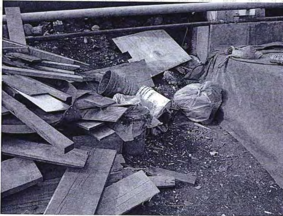
FOTO N° 8: Baldes con grasas (residuo peligroso) dispuesto sobre suelo natural, situado entre la zona de lavado de llantas de vehículos y la tubería de agua de TISHGO.
