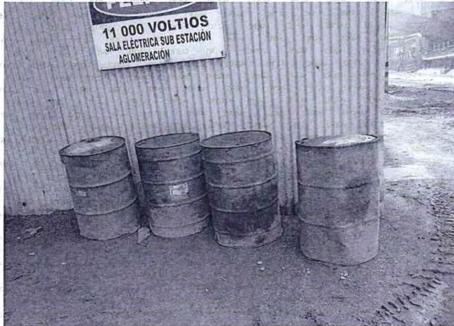
FOTO N° 17: Cilindros de aceites (residuo peligroso) dispuestos sobre suelo natural y sin protección contra las lluvias, situado al costado de la sub-estación eléctrica de aglomeración, en el sector de Sinterización.
