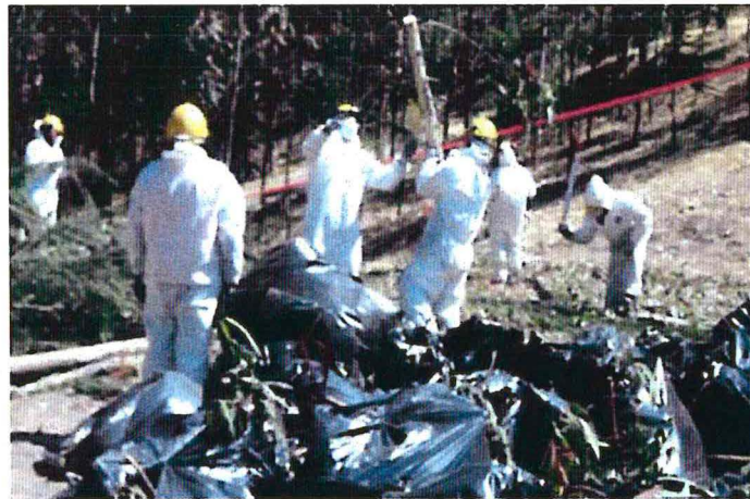
Fotografía N° 47: Tala de árboles afectados por el concentrado de cobre.
