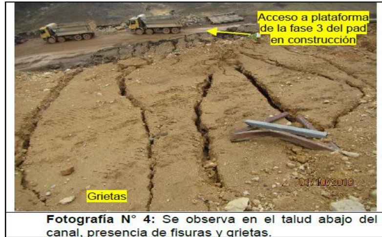
Fotografía N° 4: Se observa en el talud abajo del canal, presencia de fisuras y grietas.
