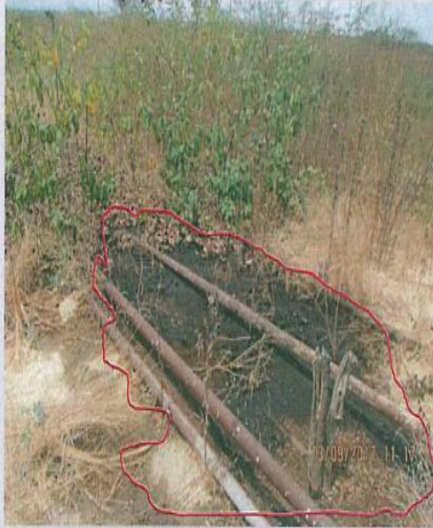
Fotografía N° 4. Batería ZA-03: Área impregnada con hidrocarburo N° 4, ubicada aproximadamente a 50 m de la Batería ZA-03, tiene una extensión aproximada de 35 m 2 , aparentemente como producto de rotura de tubería de 2" proveniente del pozo productor N° 7053 que transporta crudo al manifold de la Batería ZA-03. Coordenadas UTM – WGS 84: 480175 E, 9529920 N.
