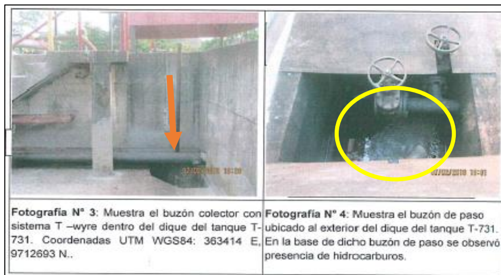
Figura 4. Buzón interior (izquierda) y exterior (derecha) del dique del Tanque 731 50 .
