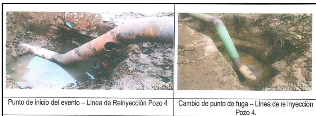
Figura 2. Línea de reinvección
