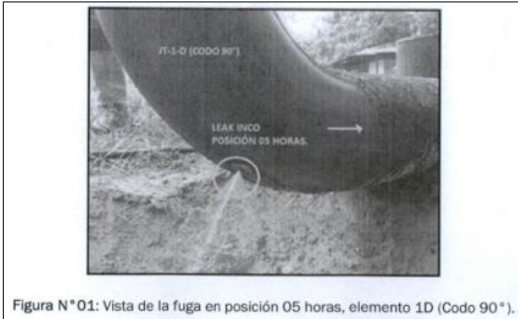
Figura 1. Vista del punto de falla
