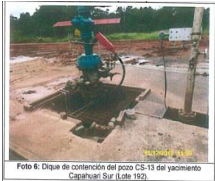
Figura 2. Acta de Supervisión
