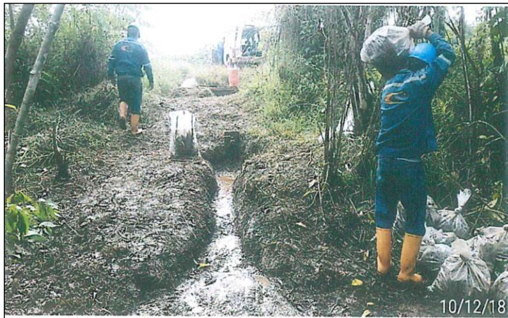
Figura 5. Vista desde el área afectada hacia el Sump Tank Fuente: Reporte Final de Emergencias Ambientales
