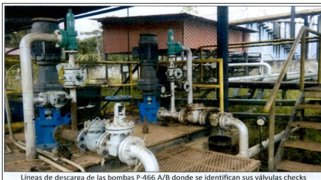
Figura 3. Válvulas check de las bombas P-466 A/B (escrito S22018000666)
