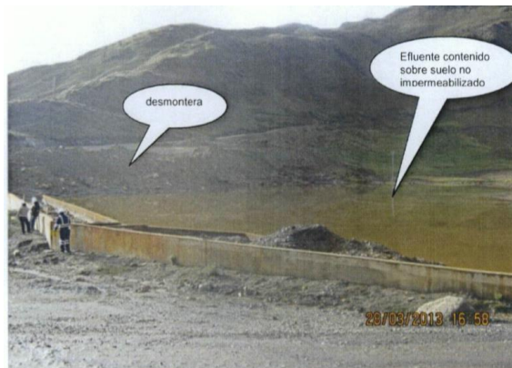
Fotografía N° 23: UEA El Recuerdo.- Hallazgo N° 11-2013: Durante la Supervisión, en la zona Pucayacu, ubicado en las coordenadas UTM WGS-84: 278769E y 8909875N se encontró una poza no impermeabilizada con contenido del efluente el cual es producto de las aguas de lluvia que hacen contacto directo con la desmontera que se encuentra adyacente a la poza, la que estaría afectando la calidad de las aguas subterráneas y del suelo del entorno . Vista del lado Este de la poza.
