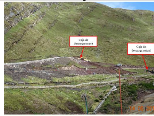
Foto 7: La construcción del nuevo canal de contingencia de concreto, no tiene las mismas coordenadas finales determinadas por el
