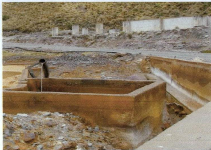
Foto N° 30. Después: Tuberías que traslada efluente del HX-2400 hacia salida de la poza de almacenamiento de agua de Pucayacu, para su retorno a mina
