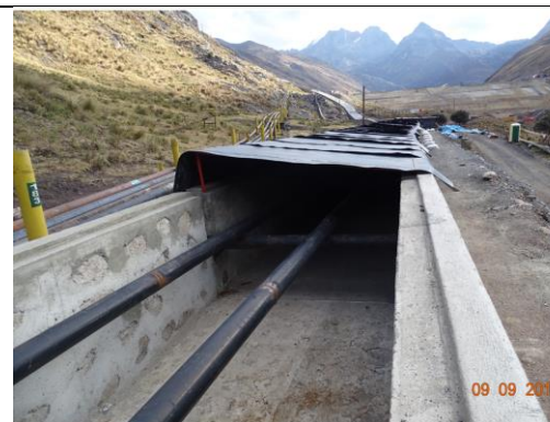
Foto 4: Instalación de tuberías de relave dentro del canal de contingencia de concreto
