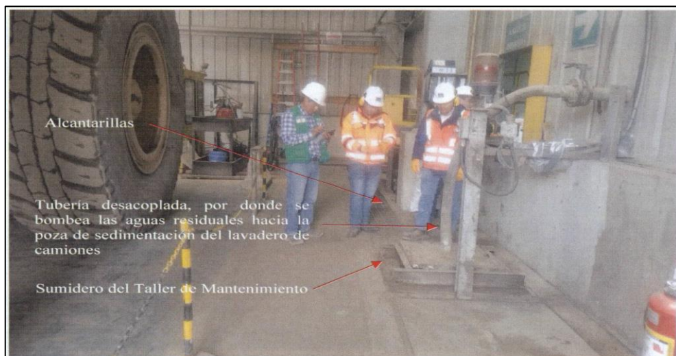
FOTOGRAFÍA N° 04.- Vista interna del Taller de mantenimiento, en donde se verificó que la tubería de 4 pulgadas por donde se bombean las aguas residuales captadas en el sumidero hacia la poza de sedimentación del lavadero de camiones, se encontraba desacoplada.
