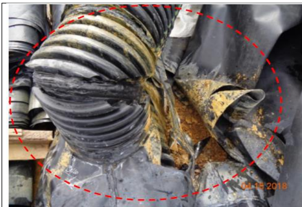
Fotografía N° 43: Hecho Detectado N° 1. Vista de tubería de aproximadamente 10" que conducía agua de proceso ubicada en las coordenadas UTM WGS 84 N 9253806 E 757031 del Pad de lixiviación.
