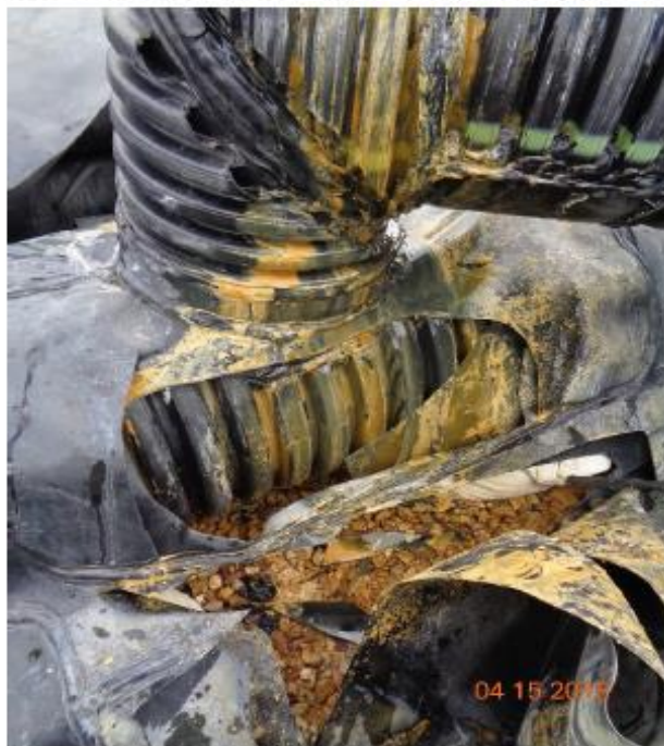
Fotografía N° 44: Hecho Detectado N° 1. Otra vista de tubería de aproximadamente 10" que conducía agua de proceso, se observa la tubería sobre el Rain-Coat.
