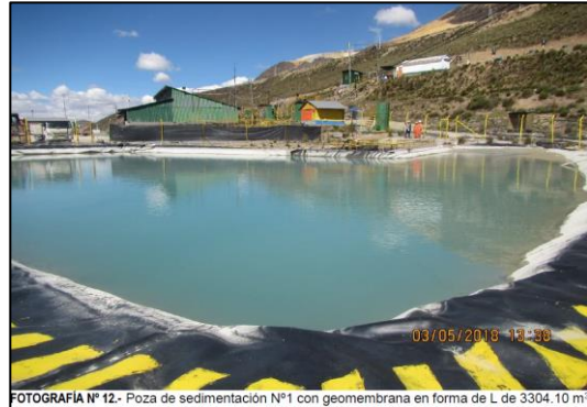
FOTOGRAFIA N° 12.- Poza de sedimentación N°1 con geomembrana en forma de L de 3304.10 m 2 de capacidad con coordenadas (DATUM WGS-84) 8717588 N, 371943 E y 4662 m.s.n.m.
