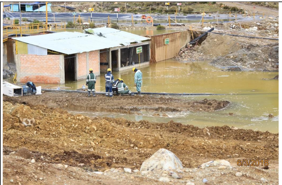
Fotografía N° 42: Estación de bombeo, nótese el agua acumulada fuera de la estación de bombeo ingresa a las instalaciones.
