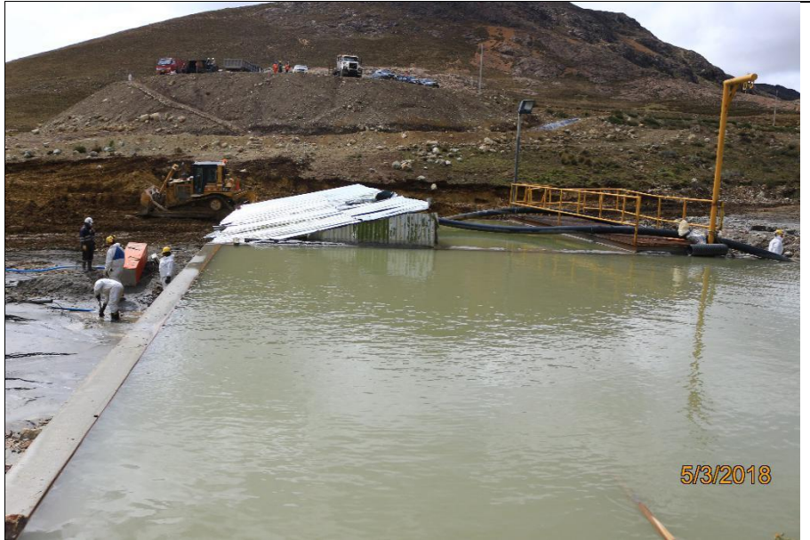
Fotografía N° 35: Poza de clarificación N°4, nótese que el agua contenida rebasa la capacidad máxima de almacenamiento.
