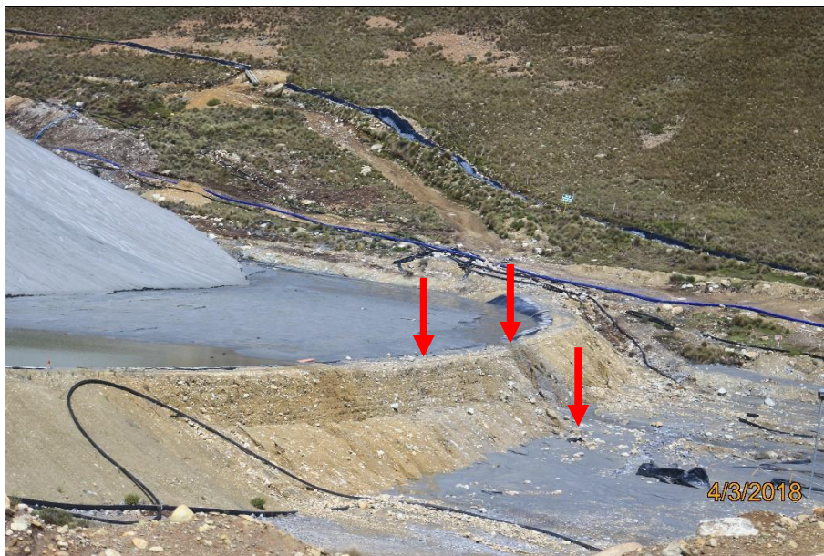
Fotografía N° 9: Nótese el dique de contra fuerte que superó el volumen máximo y desbordó los finos arrastrados quebrada abajo.
