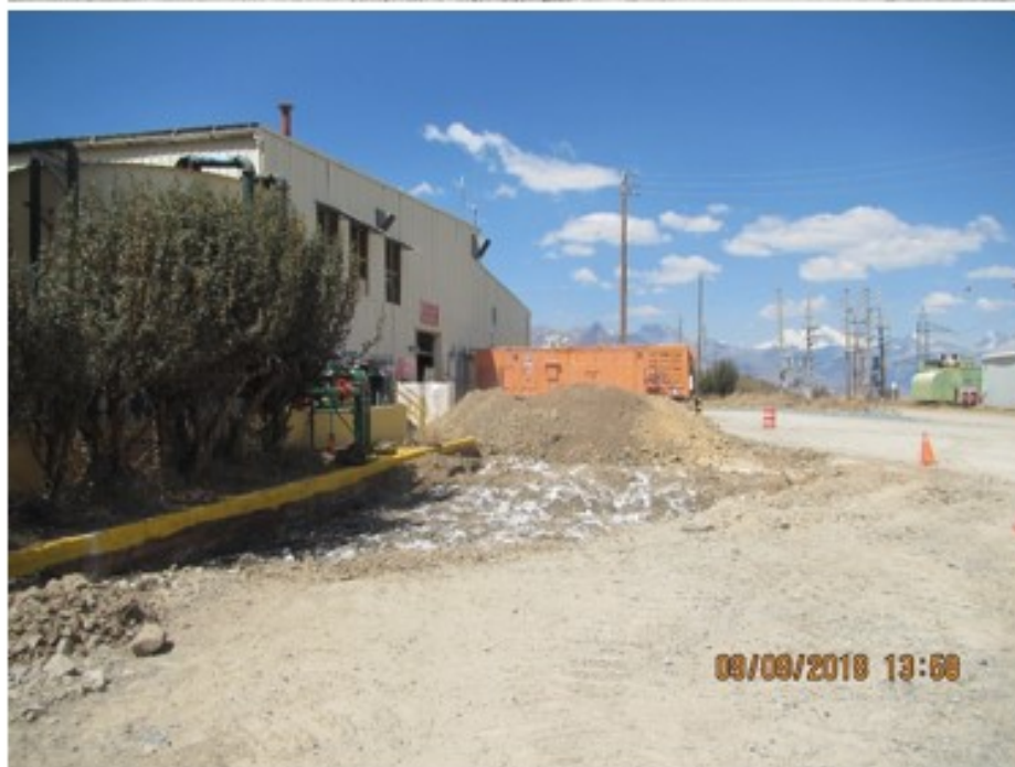
Fotografía 6: Zona N° 2 que entró en contacto con la solución cianurada, con coordenadas Datum WGS 84 N: 8951858, E: 0216357, con un área aproximada de 102 m 2 , donde se verificó que el administrado delimitó los límites físicos del derrame, colocó barreras de contención, acopió suelo industrial con solución cianurada. Asimismo, se observó una sustancia blanquecina en la superficie que estuvo en contacto con la solución cianurada, a lo cual el administrado refiere correspondería a hipoclorito de sodio en solución.
