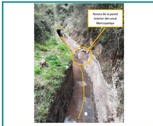
Fotografía N° 14: Vista del canal Marcopampa aguas abajo de la zona de la antigua planta Chichirín se observa rotura de la pared interna del canal. (Presunto incumplimiento N.° 1)
