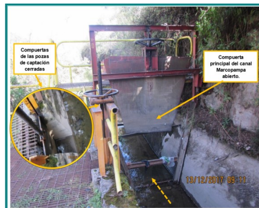
Fotografía N° 17: Vista de las compuertas del canal Marcopampa y pozas de captación. (Presunto incumplimiento N.° 1 y 3).
