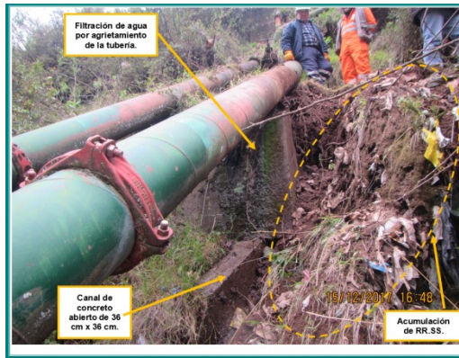
Fotografía N° 21: Vista de tuberías de la poza de captación del canal Marcopampa, asimismo se observa el tramo visible donde inicia un canal de concreto abierto de 36 cm x 36 cm, fugas de agua por agrietamiento de la tubería y acumulación de residuos sólidos en los alrededores. (Presunto incumplimiento N.° 1 y 2).
