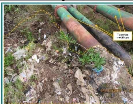
Fotografía N° 20: Vista cuatro (4) tuberías que provienen de la poza de captación de Marcopampa, en dirección a la planta concentradora Chicrín N° 2, se acumulación de residuos sólidos (bolsas, botellas plásticas, papeles y orgánicos) en los alrededores.
