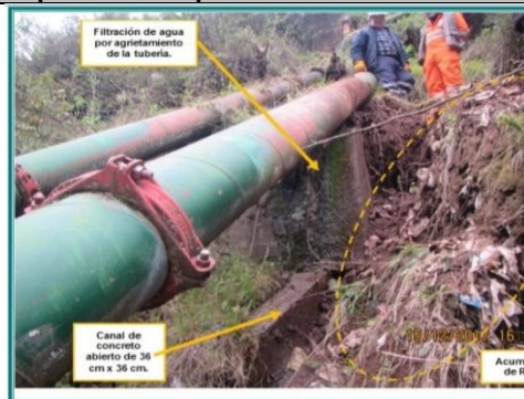
Fotografía N° 21: Vista de tuberías de la poza de captación del canal Marcopampa, así mismo se observa el tramo visible donde inicia un canal de concreto abierto de 36 cm. fugas de agua por agrietamiento de la tubería y acumulación de sólidos en los alrededores.
