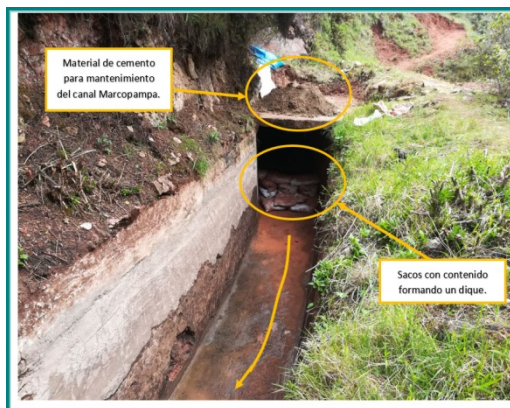
Fotografía N° 15: Vista de un tramo del canal Marcopampa, se observa acondicionamiento de materiales (sacos con contenido, formando un dique) para el mantenimiento de canal. (Presunto incumplimiento N.° 1)
