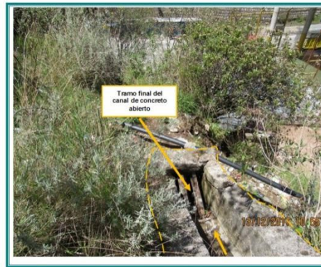
Fotografía N° 23: Vista del tramo final del canal de concreto abierto de 36 cm x 36 cm de rectangular, donde se observa una rejilla metálica para evitar el paso de residuos sólidos gruesos. A partir de este punto, el canal continúa su curso bajo tierra.
