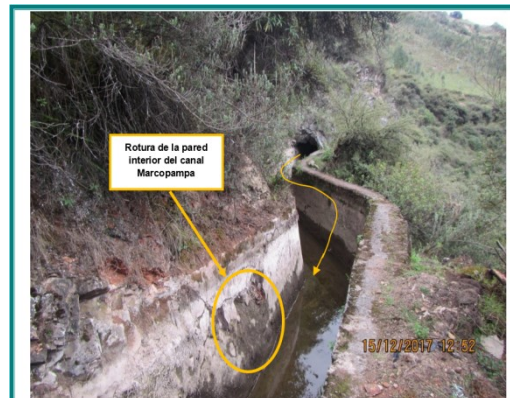
Fotografía N° 11: Vista del canal Marcopampa, tramo ubicado a la margen derecha del río Huallaga, se observa rotura de la pared interna del canal. (Presunto incumplimiento N.° 1).
