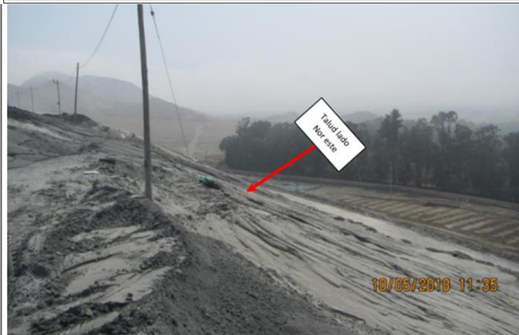
Fotografía N° 9. Vista panorámica del talud aguas abajo del depósito de relaves N°3, en el lado Nor Este (flecha roja) en el que se verificó que el talud se encontraba sin manta de polipropileno. La vista fue tomada desde el extremo Nor Este del depósito.
