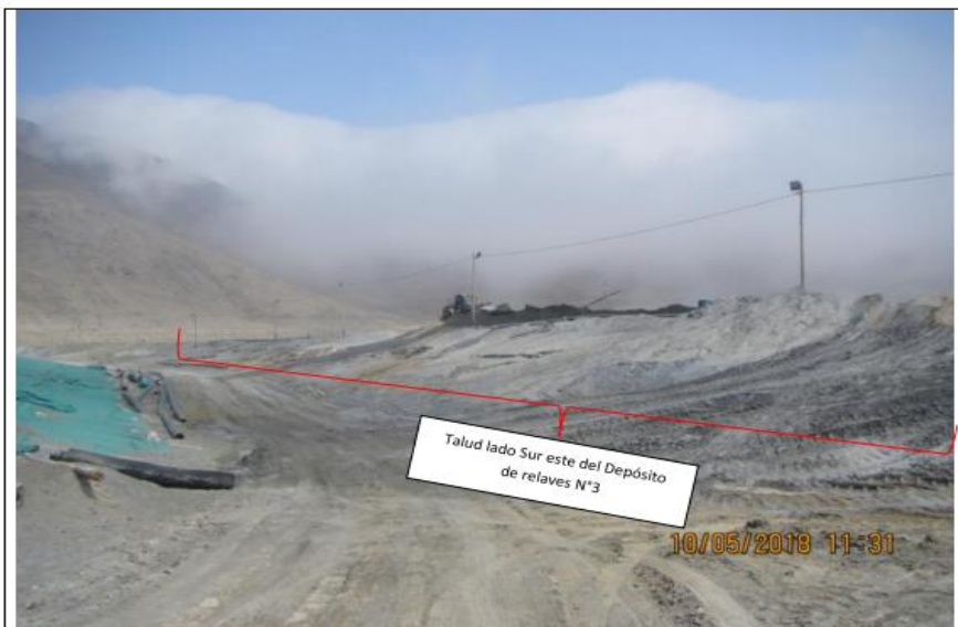
Fotografía N° 8. Vista panorámica del talud aguas abajo del depósito de relaves N° 3, en el lado Sur Este, en el que se verificó que el talud se encontraba sin manta de polipropileno. La vista fue tomada desde el extremo Nor Este del depósito.
