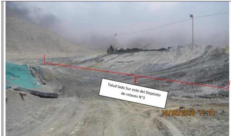
Fotografía N° 8. Vista panorámica del talud aguas abajo del depósito de relaves N° 3, en el lado Sur Este, en el que se verificó que el talud se encontraba sin manta de polipropileno. La vista fue tomada desde el extremo Nor Este del depósito.
