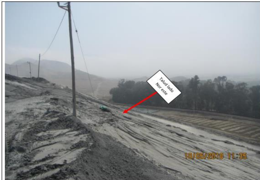
Fotografía N° 9. Vista panorámica del talud aguas abajo del depósito de relaves N°3, en el lado Nor Este (flecha roja) en el que se verificó que el talud se encontraba sin manta de polipropileno. La vista fue tomada desde el extremo Nor Este del depósito.
